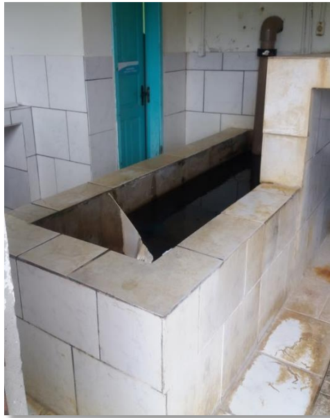
Figura 9. Vista geral da entrada de água na câmara de contato e abertura de inspeção.
