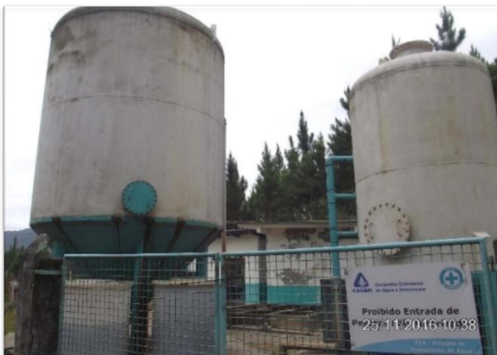
Figura 6. Floccodecantador e o Filtro de areia.
